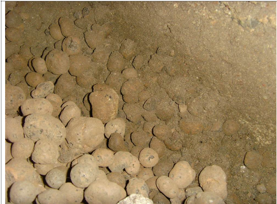
Kuva 15.: Vanhan osan ryömintätilan kevytsoratäytteessä esiintyy kosteutta heti kuivan pintakerroksen alla.
