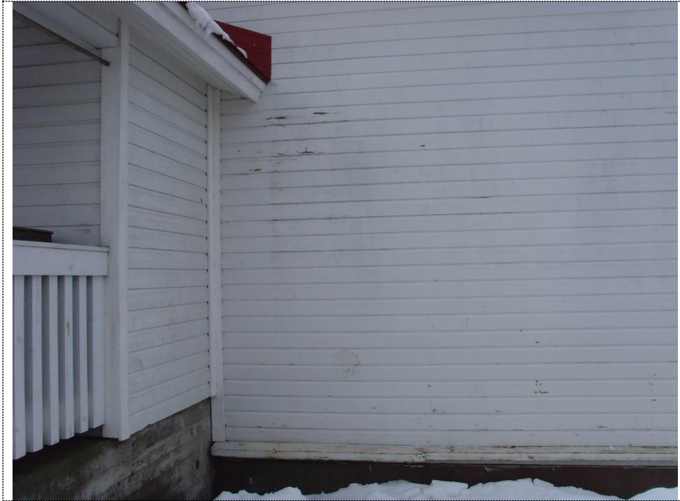
Kuva 3.: Julkisivupinnoilla esiintyy useissa paikoissa kosteuden aiheuttamia jälkiä.
