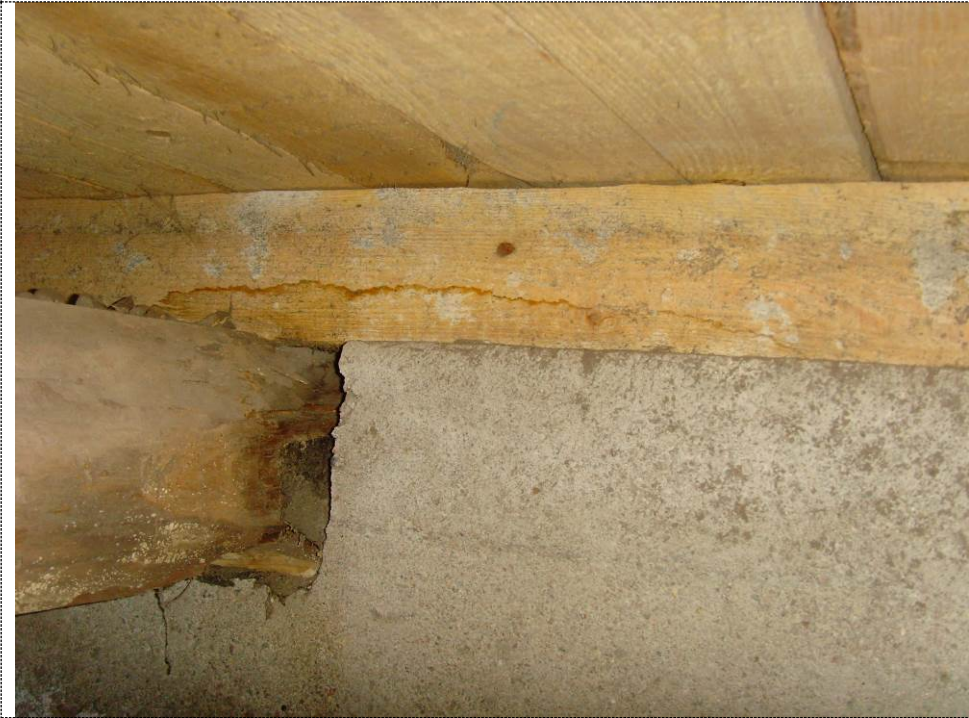
Kuva 13.: ATK-luokan kohdalla alapohjan kannatinhirsien päissä esiintyy lahovaurioita.
