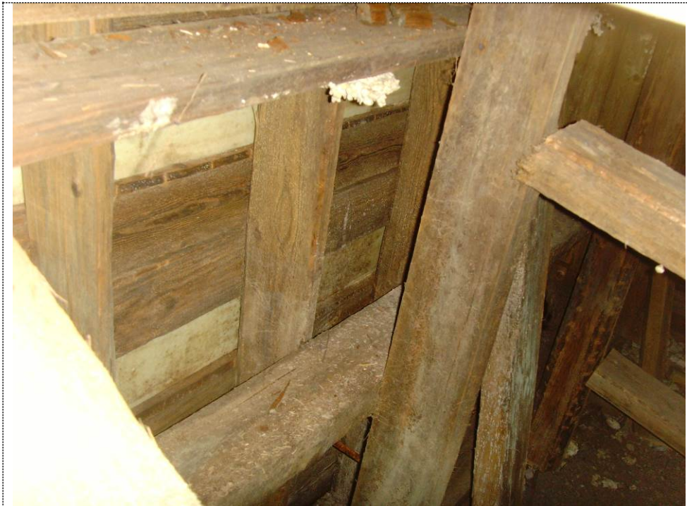
Kuva 23.: Kuistin sisämuotin tukipuissa esiintyy silmin nähtävää sienirihmastoja.
