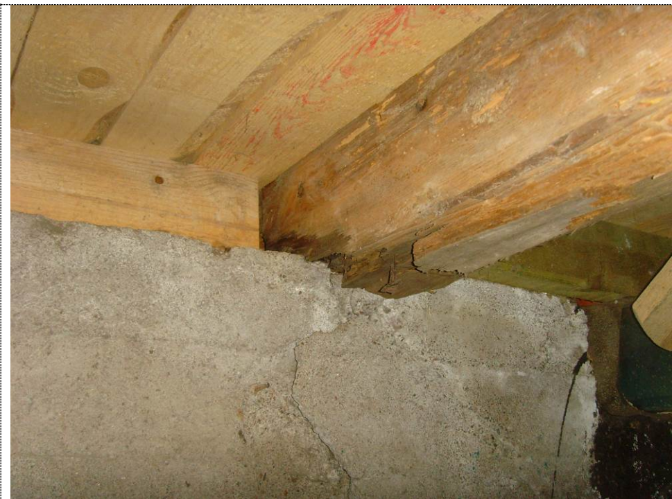
Kuva 14.: ATK-luokan kohdalla alapohjan kannatinhirsien päissä esiintyy lahovaurioita.
