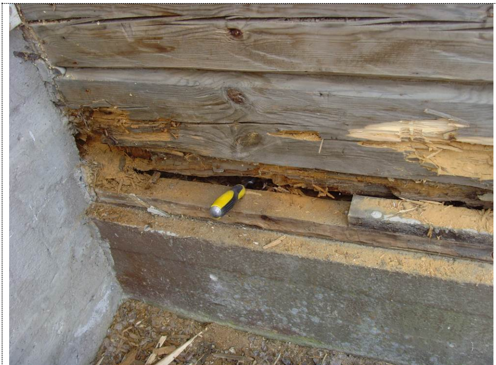
Kuva 8.: ATK-luokan kohdalla alahirsissä esiintyy lahovaurioita.
