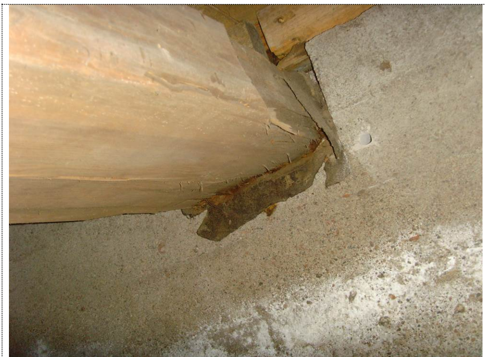
Kuva 12.: ATK-luokan kohdalla alapohjan kannatinhirsien päissä esiintyy lahovaurioita.
