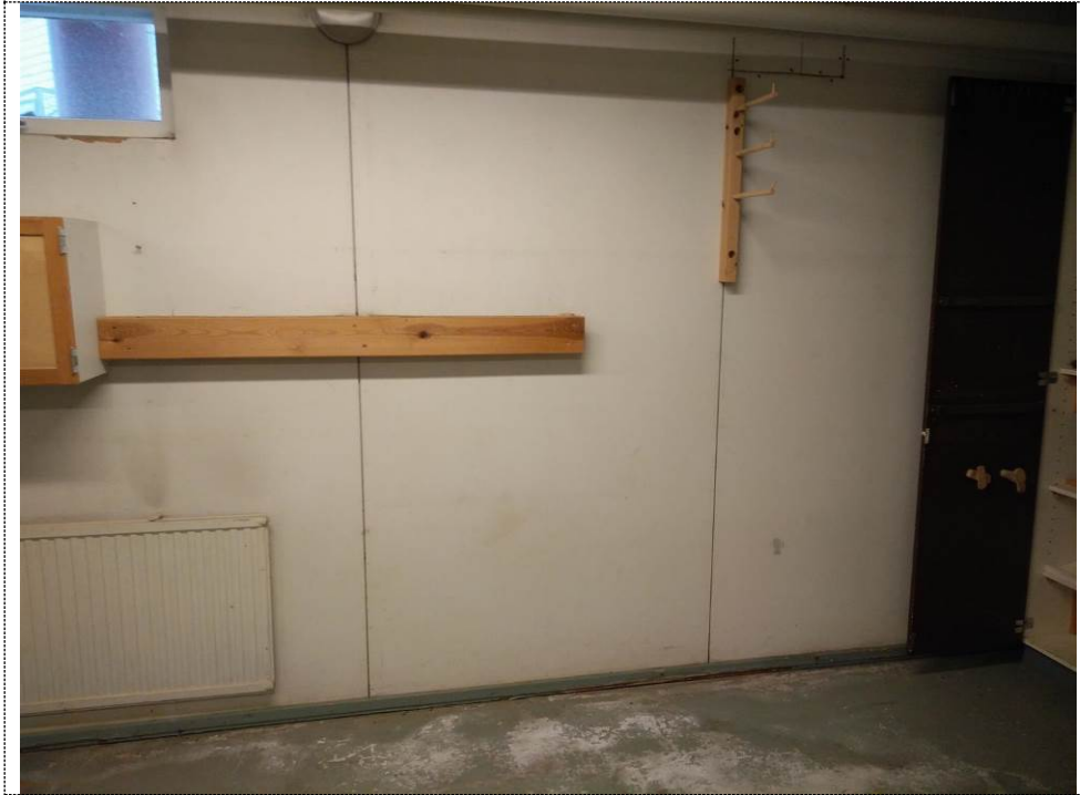
Kuva 1.: Kellariseinän lisälämmöneristeissä on simin nähden kosteusvaurioita.
