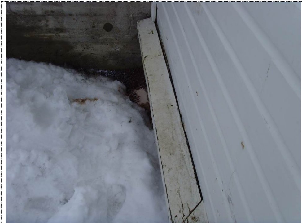
Kuva 2.: Ulkoseinän tippalankku on paikoin epätiivisti kiinni julkisivulaudoituksessa.
