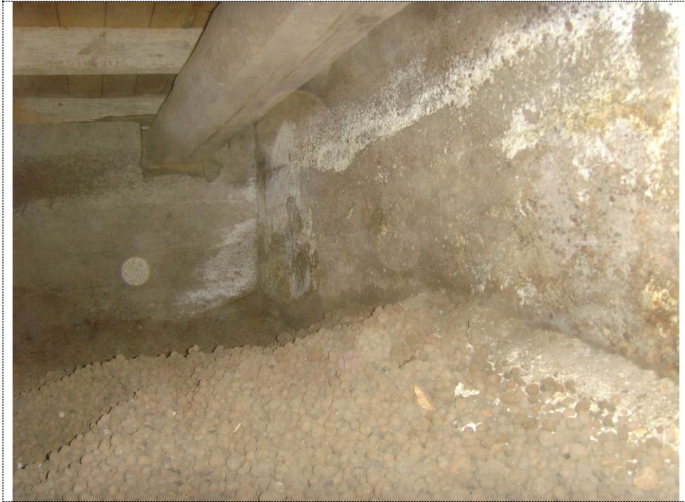
Kuva 21.: Sokkelin sisäpinnoilla esiintyy runsaasti kalkkihärmää, joka on kostea.
