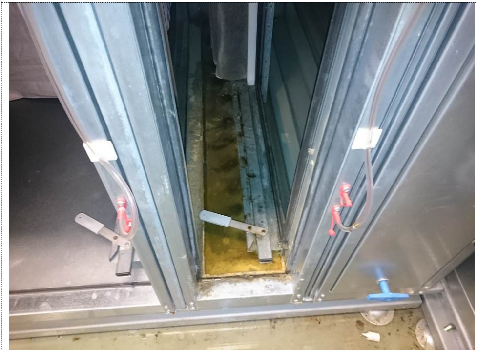
Kuva 28.: Tuloilmakoneen esisuodattimen kaukalo on täynnä vettä.
