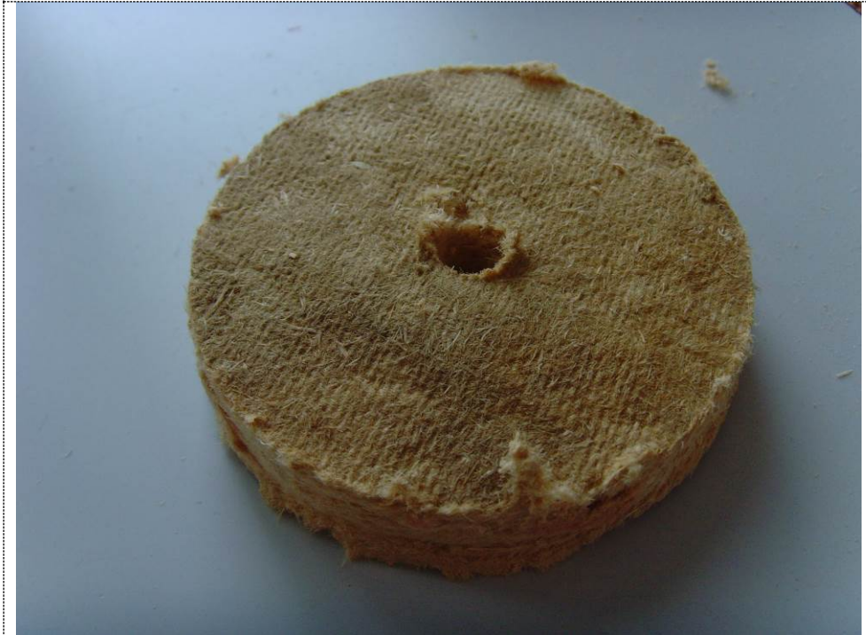
Kuva 7.: Huoneen 3 ulkoseinän puukuitulevyssä esiintyy kosteuden aiheuttamia jälkiä.
