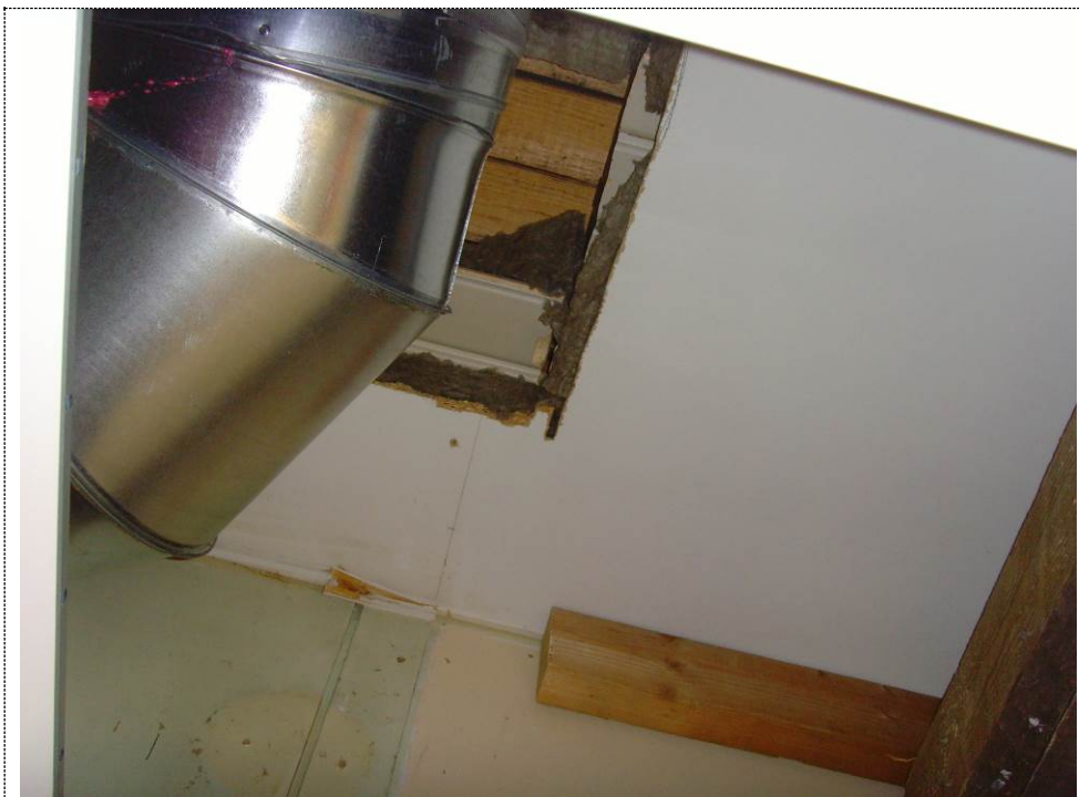
Kuva 24.: Opettajienhuoneen kohdalla katon vanhoja lisälämmöneristeitä ei ole purettu pois.
