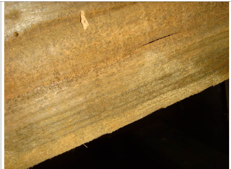
Kuva 22.: Kuistin sisämuotin tukipuissa esiintyy silmin nähden homekasvustoa.
