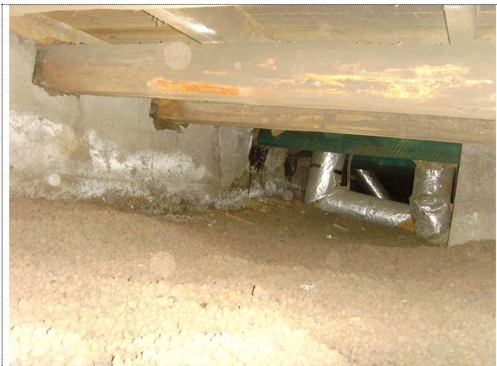
Kuva 20.: Sokkelin sisäpinnoilla esiintyy runsaasti kalkkihärmää, joka on kostea.
