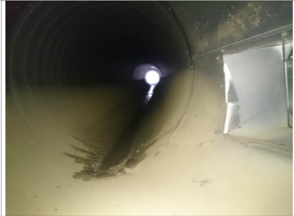
Kuva 27.: Tuloilmajärjestelmään pääsee kulkeutumaan ulkopuolista kosteutta (vesisade).
