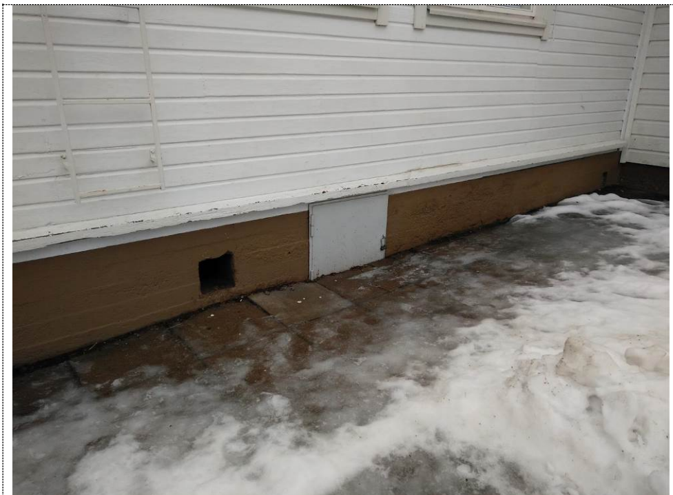
Kuva 10.: Sade- ja sulamisvedet jäävät osin rakennuksen seinustoille.
