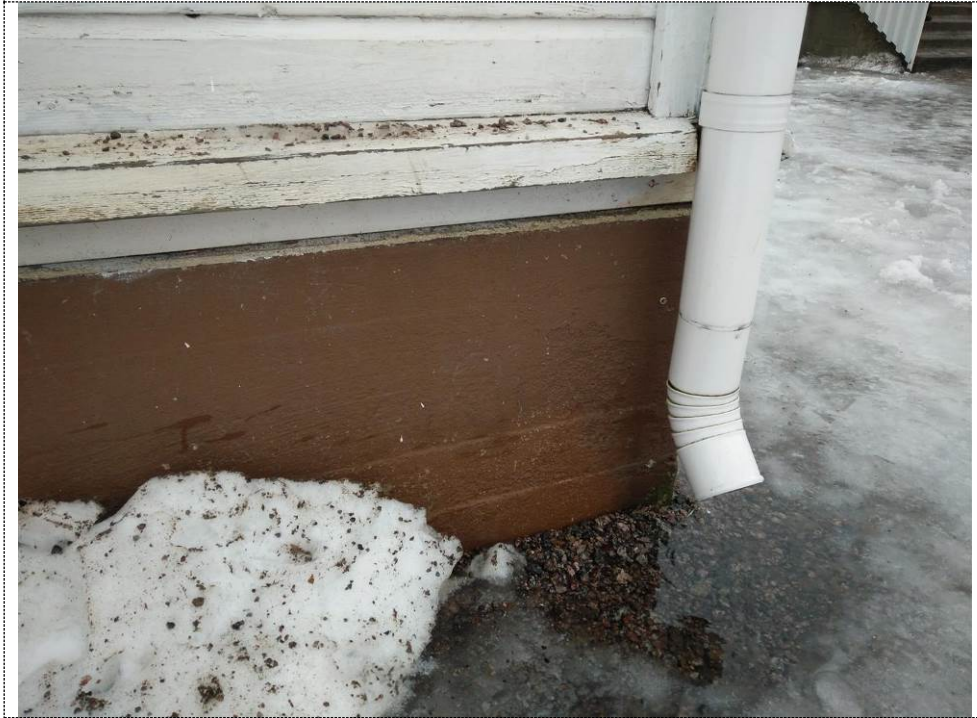
Kuva 9.: Sade- ja sulamisvedet jäävät osin rakennuksen seinustoille.
