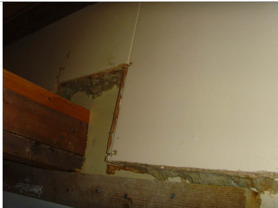
Kuva 25.: Opettajienhuoneen kohdalla alakaton yläpuolelta vanhoja ulkoseinän lisälämmöneristeitä ei ole purettu pois.
