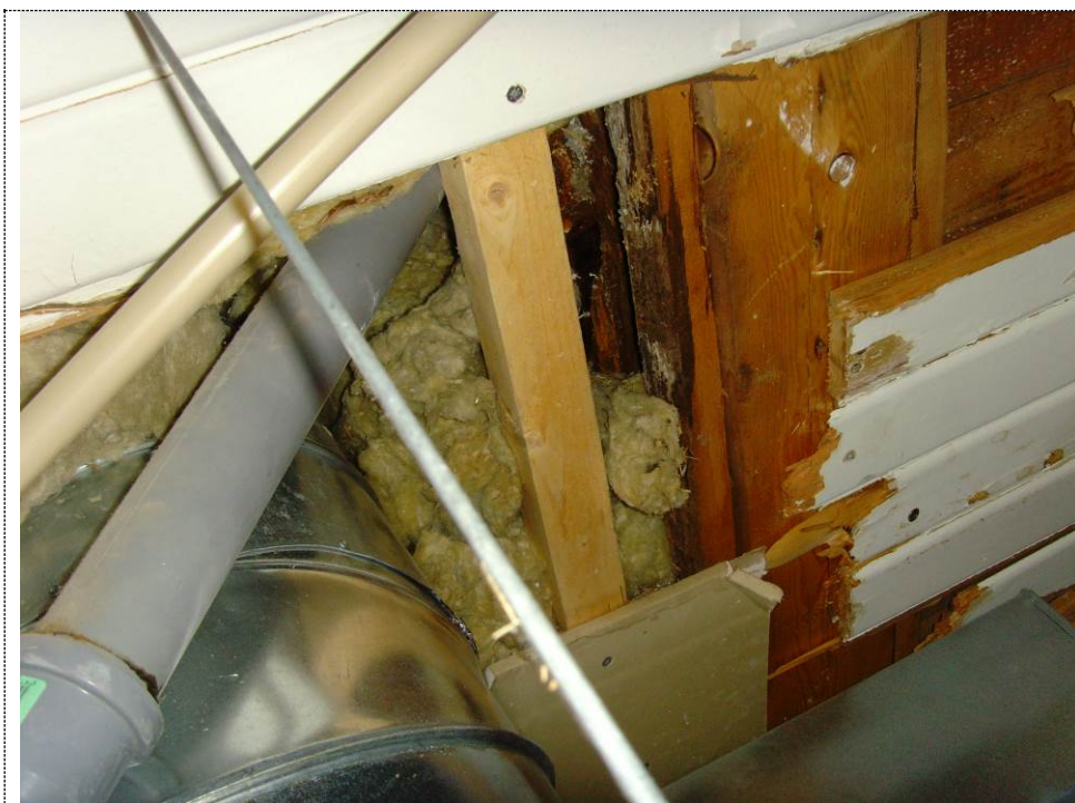
Kuva 26.: Opettajienhuoneen kohdalla välipohjassa esiintyy kosteusvaurio yläkerran WC:n kahdalla.
